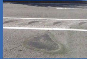
穴ぼこを補修し、安全を確保！
