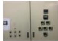
大半が竣工当時の中央監視制御関係
