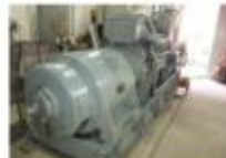
不調のある非常発電設備
