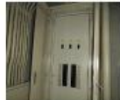
内部劣化が進む電灯設備等
