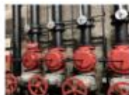
不具合のある消防設備関係（アーム弁）
