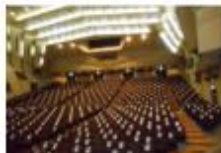
独特な形状で落下防止ネット設置が困難な特定天井（大ホール）
