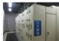
一部更新済みの受変電設備
