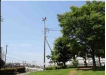
防災無線屋外子局全体
