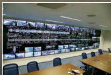
大規模災害・事故が発生した際の対策本部となる危機管理室。複数のモニターで現場の状況を把握し、対応します
