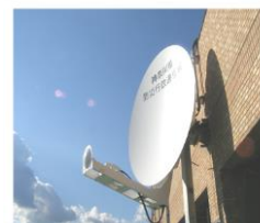
【市役所屋上の衛星アンテナ】
