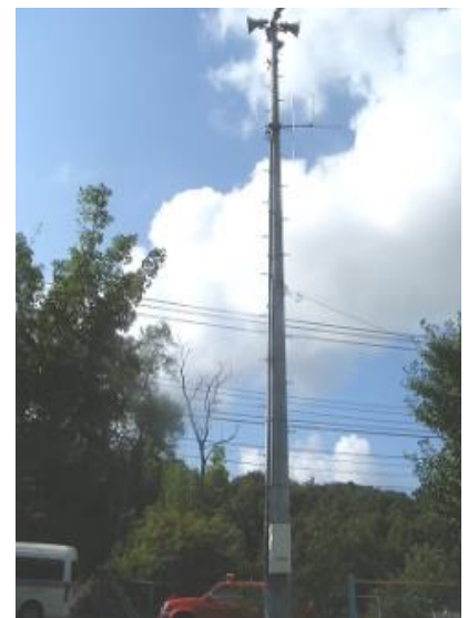
【屋外子局設置状況】
