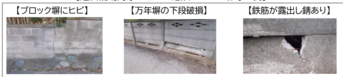
【過去補助対象となった危険ブロック塀等の例】
