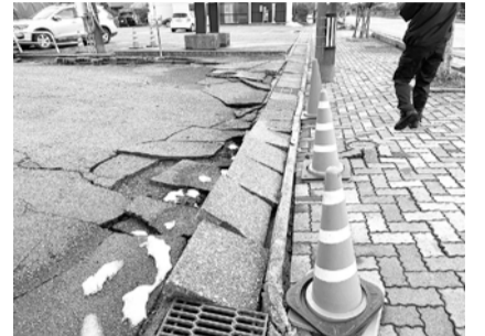
破損したアスファルトや道路側溝
