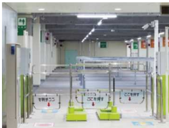
写真 7-3 自動ゲートシステムの例
