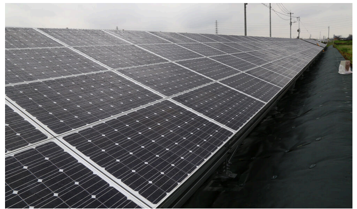
大田スポーツ広場裏太陽光パネル
