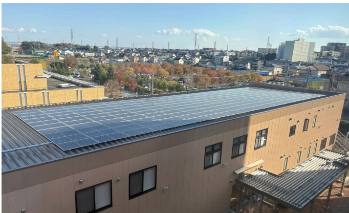
こどもみらいプラザ屋上の太陽光パネル
