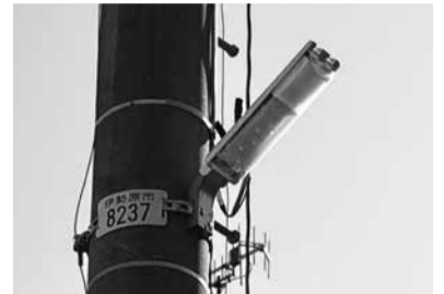
設置された防犯灯
