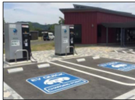
EV 車用充電設備
