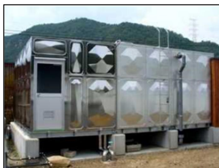
飲料水兼用貯水槽
