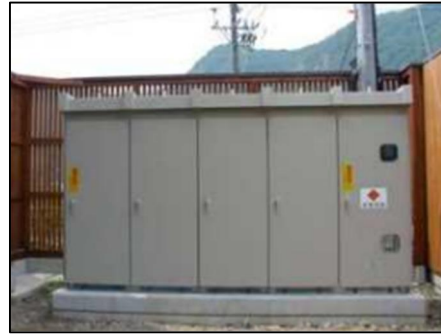
非常用発電機
